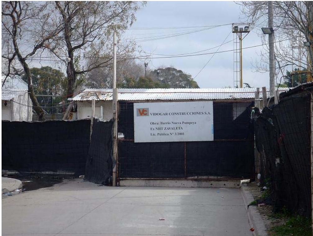
NHT – ZAVALETA – Barrio de Barracas – OBRADOR: sigue estando en el lugar.
