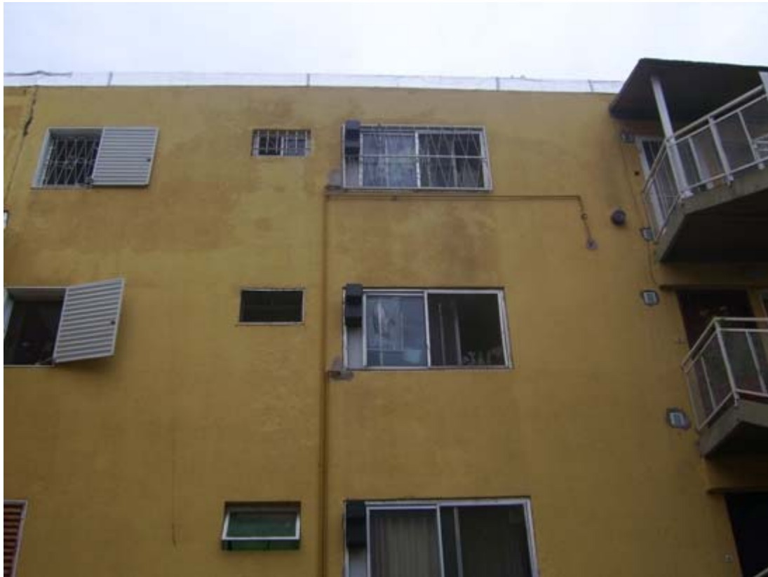
Vista de una conexión externa de gas en altura.
