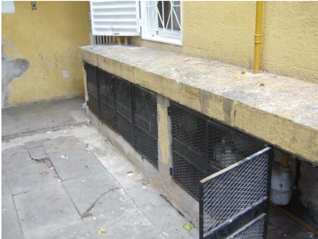
Vista general de la cabina de gas para el modulo de viviendas.
