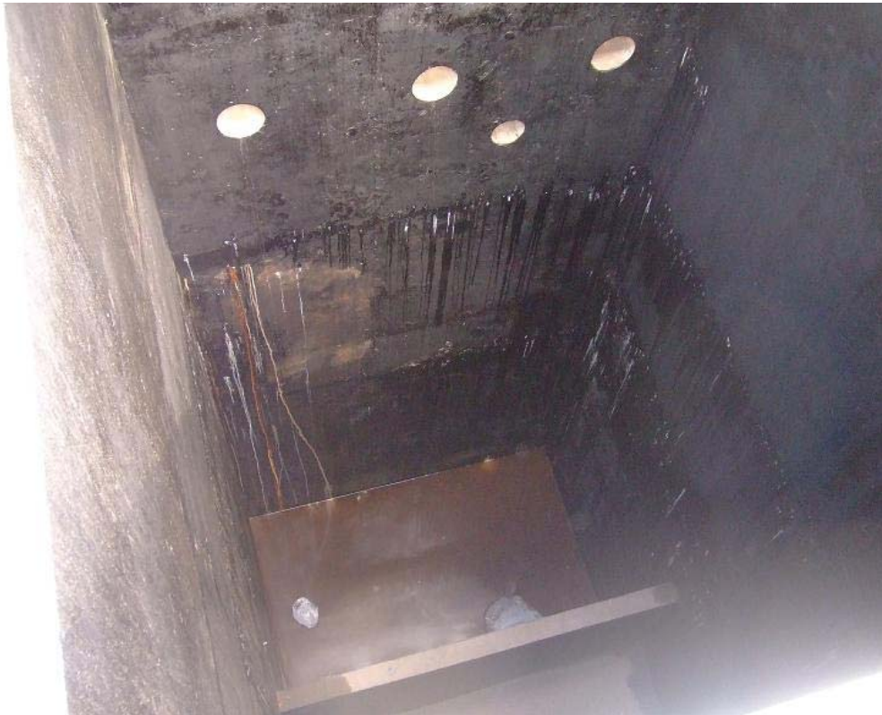
CAMARA DE TRATAMIENTO DE AGUA – Obra civil terminada – Faltan las Bombas.
