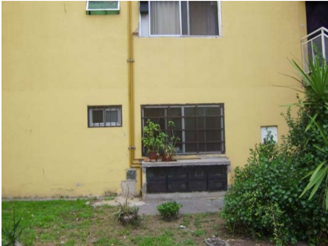
Gabinete de medidores y subida de cañerías de gas.
