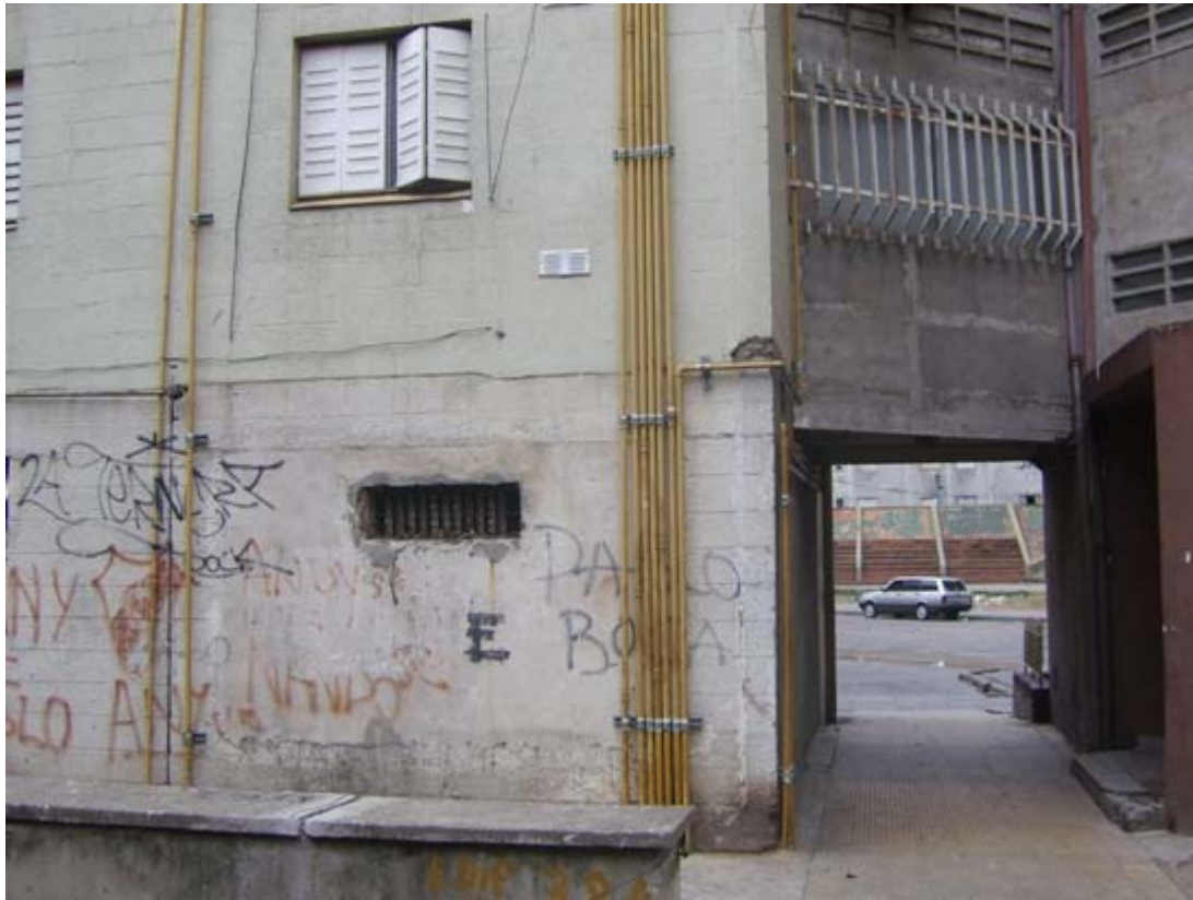
Subida de cañerías de Gas
