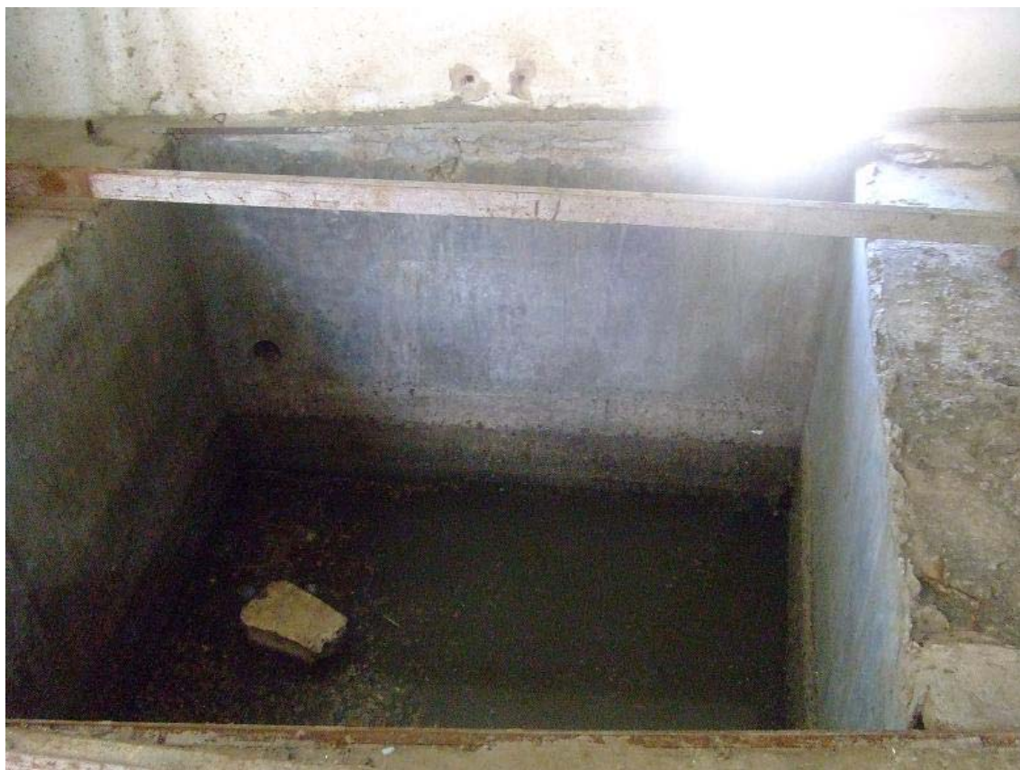
Vista del pozo cloacal, en el mismo se arrojan residuos obstruyendo el sistema. Abertura de 30 x 30 sin protección.
