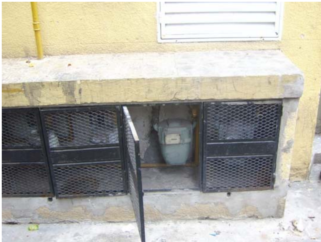
Cabina de gas en Barrio Soldati.
